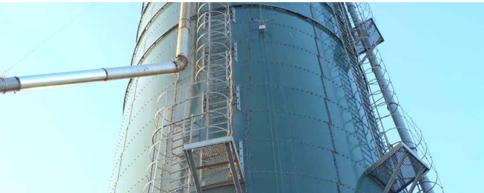
Gastæt silo monteret med stiger og rygbøjler. Bemærk platformene for hver 6-8 meter.
